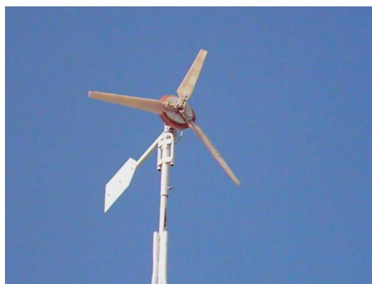
AEROGENERADOR DE EJE HORIZONTAL DE TIPO ARTESANAL
