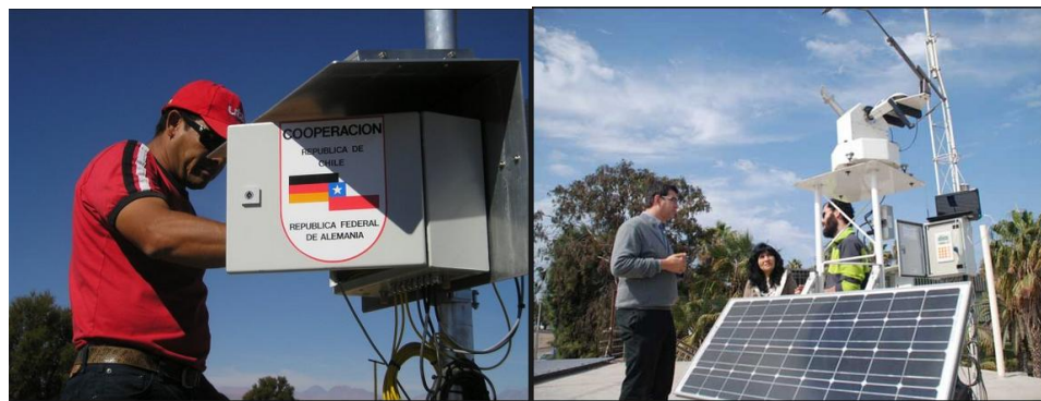
Fig.- montaje de instrumentos.
